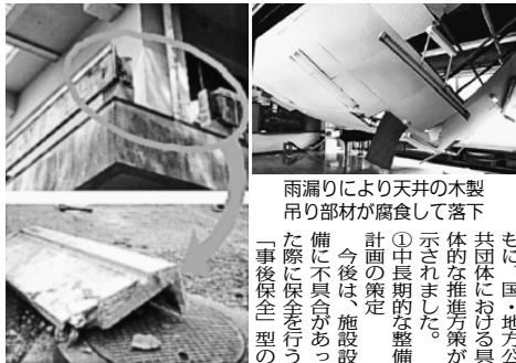
老朽化による手すりの落下
